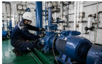
Aux. Machinery Repair
