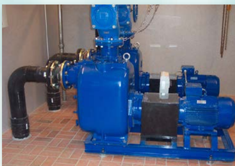
Tørtopstillet, selvansugende pumpestation klar til brug
